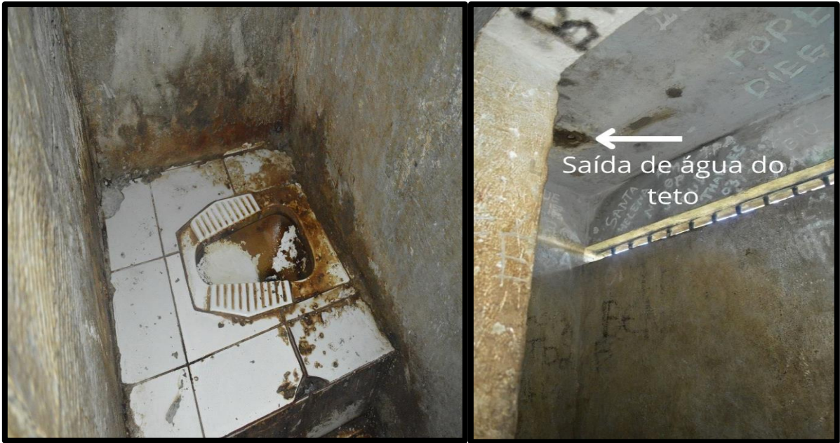
Figuras 142 e 143: Vaso sanitário. Banheiro sem chuveiro (cano do teto). Fonte: MNPCT.
