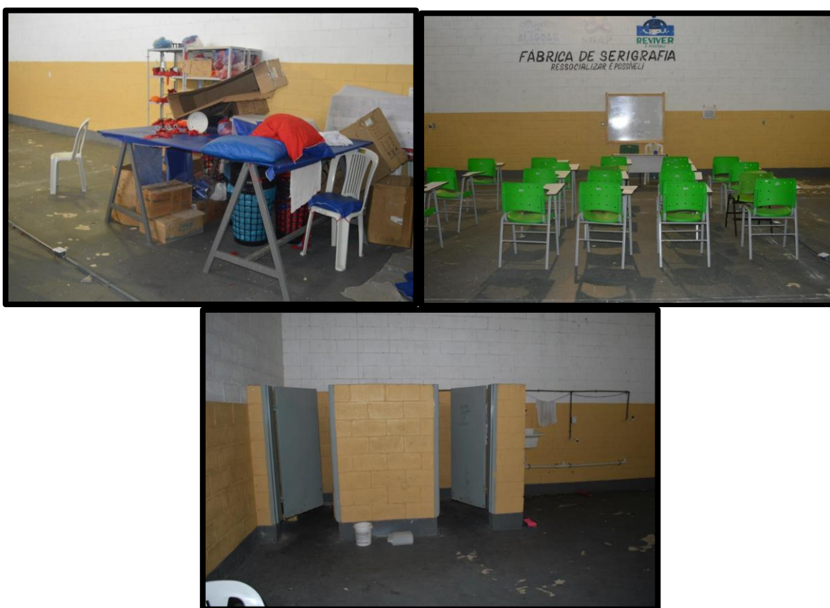
Figuras 106, 107 e 108: Oficina de trabalho desativada e banheiro sem condições de uso. Fonte: MNPCT.
