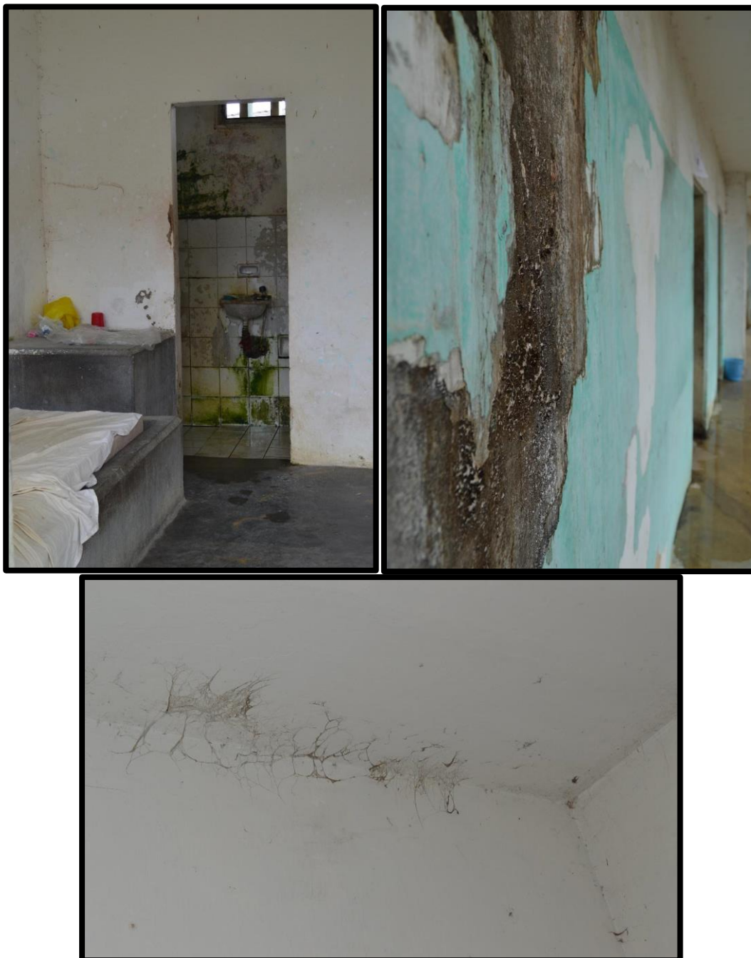
Figuras 44, 45 e 46: Estrutura sem manutenção e suja dos alojamentos. Fonte: MNPCT.
