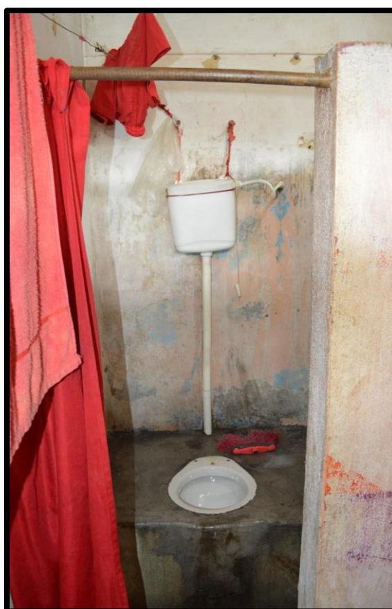
Figura 18: Banheiro sem adaptação para pessoa com deficiência. Fonte: MNPCT.
