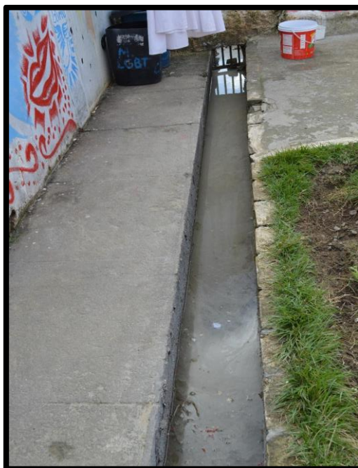
Figura 22: Calha de esgoto dentro da Ala LGBT. Fonte: MNPCT.
