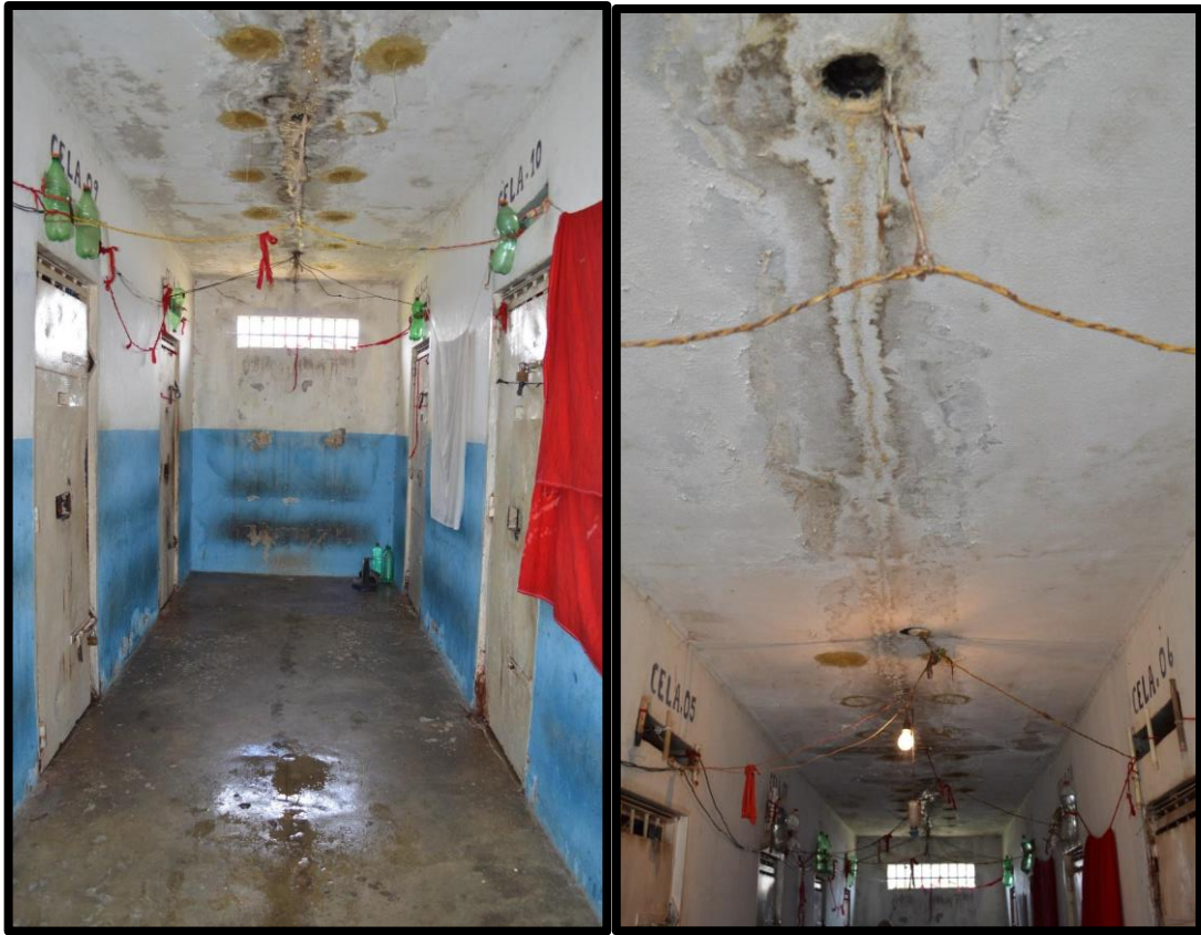
Figuras 7 e 8: Infiltrações e fios elétricos expostos. Fonte: MNPCT.
