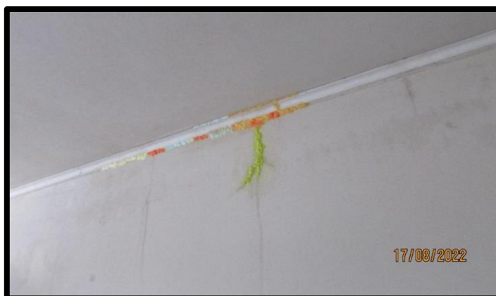
Figura 94: Infiltrações na cela cobertas com sabão. Fonte: MNPCT.
