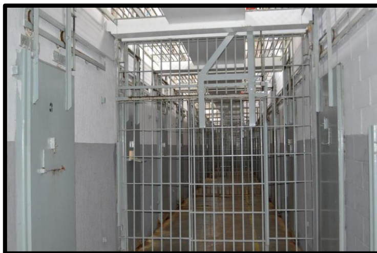
Figura 105: Portas das celas sem ventilação cruzada. Fonte: MNPCT.
