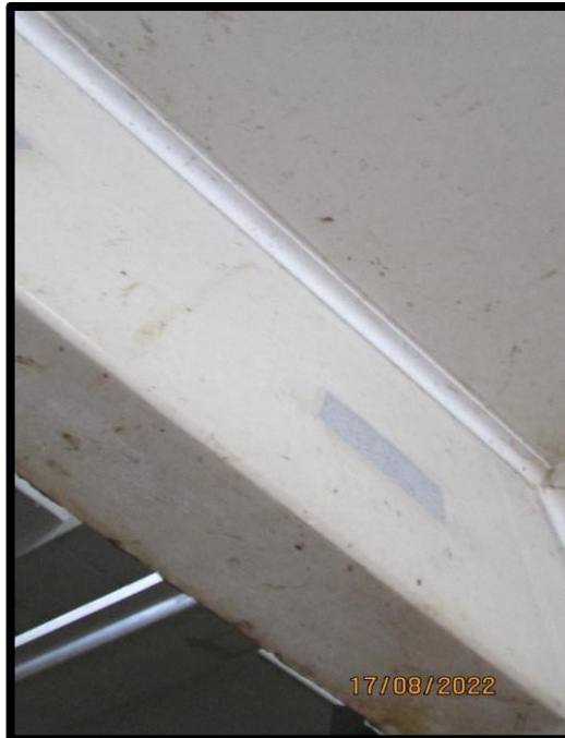
Figura 61: Ponto de iluminação cimentado. Fonte: MNPCT.
