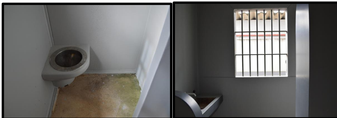
Figuras 88 e 89: Banheiro de cela da triagem. Fonte: MNPCT.
